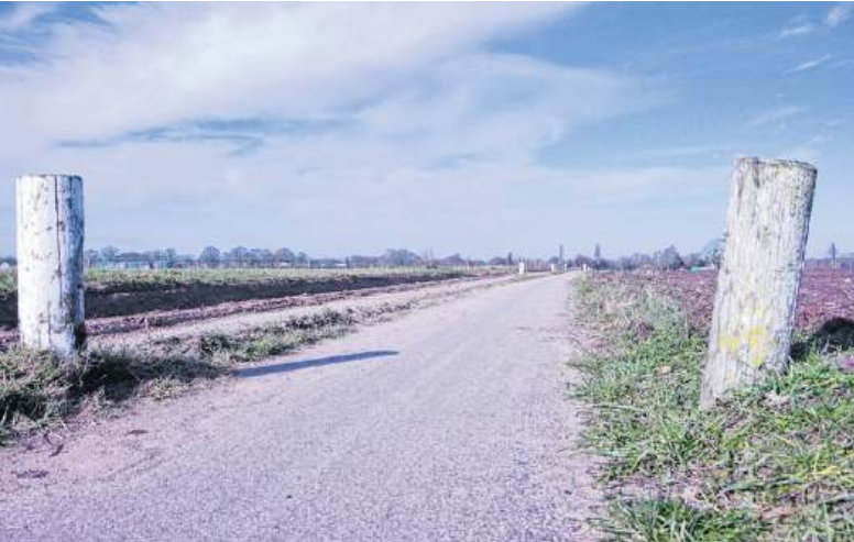
Het fietspad langs de Molenweg bij de Wouterseweg. Amper 120 cm breed en de paaltjes aan weerszijnden maken het elkaar passeren er niet gemakkelijker op.
